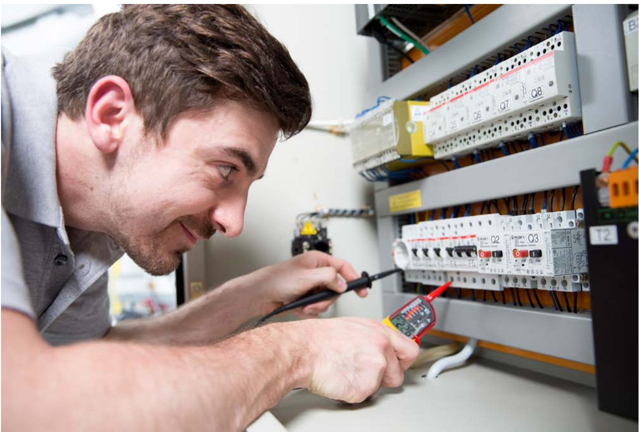
Abbildung 9: Messungen am Schaltschrank (Quelle: ZVEH)
